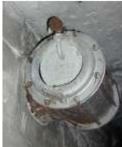
Lüftungsklappen KoB- ra
