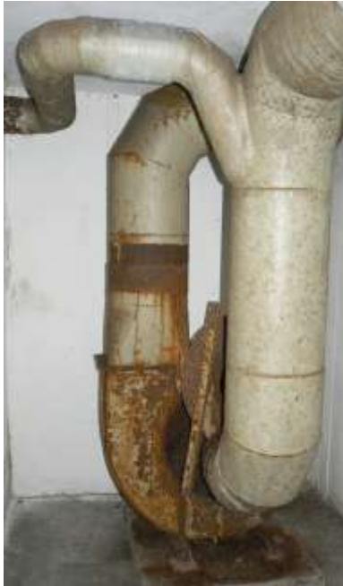
Fliehkraft-Normalbelüfter nebst Rohrleitungen
